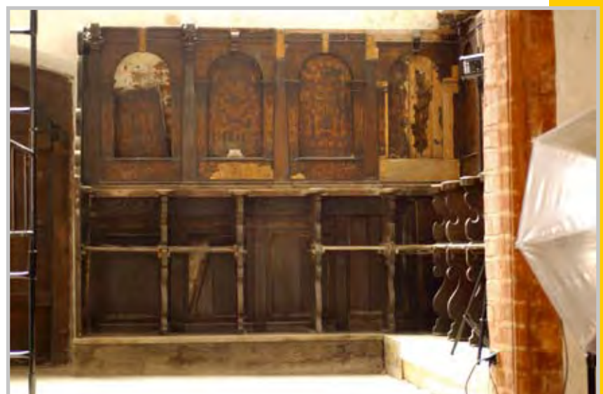
Abb. 4 Südseite des Gestühls mit unpassenden Teilen unter den Sitzen. Foto: Joachim Dramm
